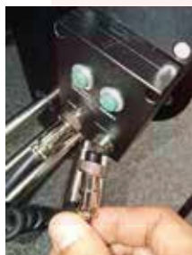
ケーブルリール側
